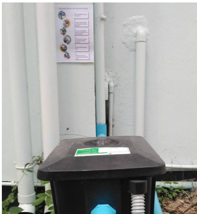
ถังดักไขมัน จำนวน 1 จุดพร้อมป้ายขั้นตอนการทำความสะอาดบ่อดักไขมัน
